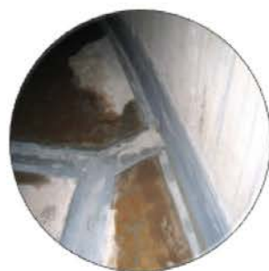
Негерметичные деформационно-осадочные швы
