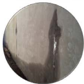
Негерметичные межпанельные швы
